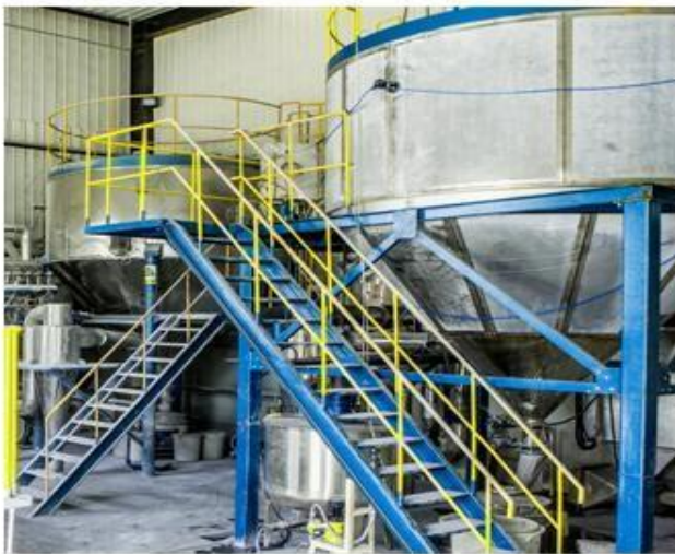
工厂车间场景图：造粒车间
