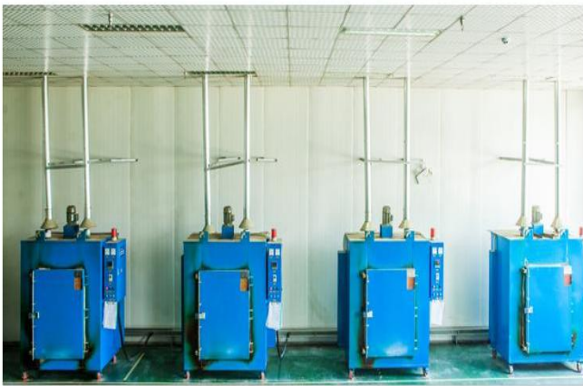
工厂车间图：箱式排胶车间
